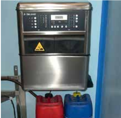
Automatische Dosierung von Melkmaschinenreiniger
