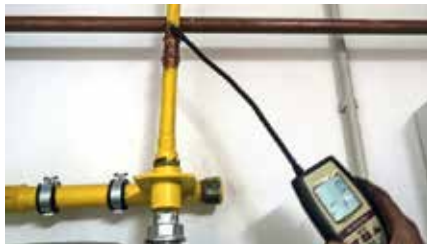
Gasspürgerät an gelb gekennzeichnetener Gasleitung
